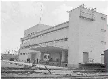
SOK:n rakennus rakenteilla 1936. Rata jatkaa Tullikatua pitkin. (Kuva: E. M. Staf, Tampereen museot)
